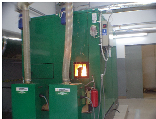
Kotłownia w Goławicach, 400kW
