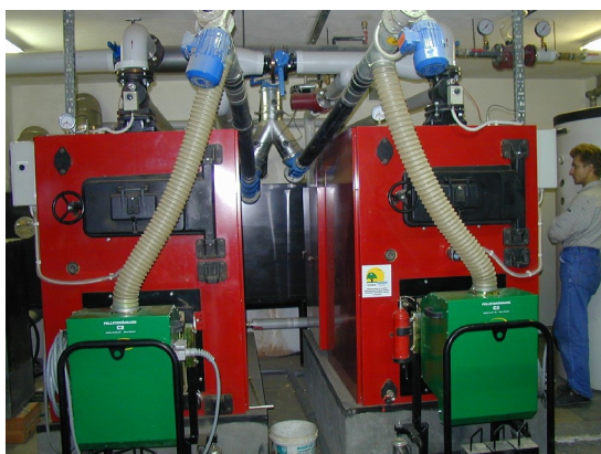
Kotłownia w Rzgowie, 2x200 kW
