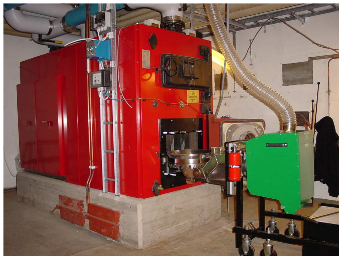
Kotłownia o mocy 300kW
