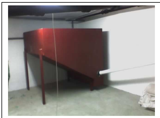
Magazyn do kotła 75kW
